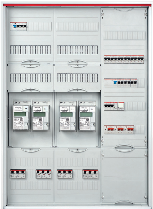
Komplettschrank ohne Überspannungsschutz
